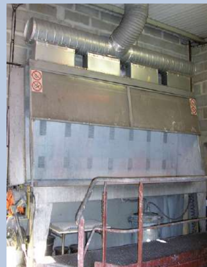
Poste de lavage n° 1.
